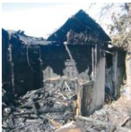
Die ordnungsgemäße Entsorgung solcher Brandrückstände sollte durch eine Fachfirma erfolgen. Foto: SLK
