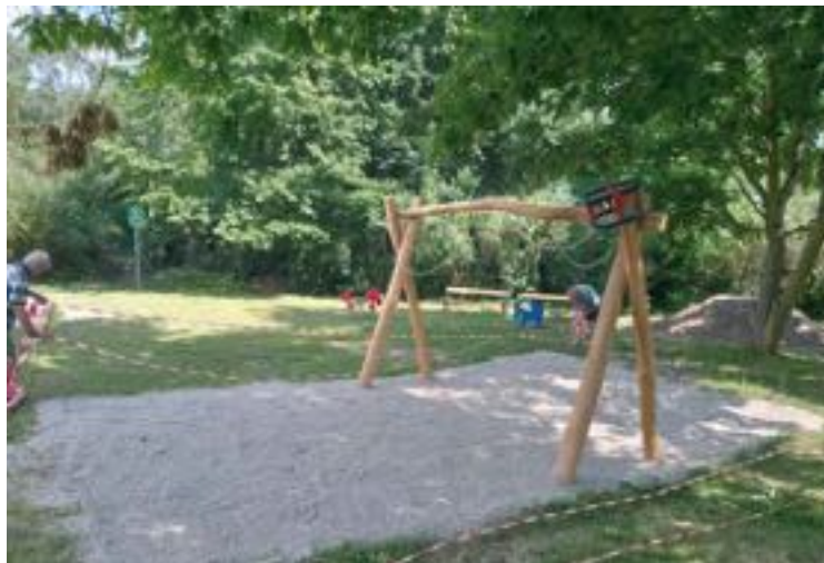
Beim Auskoffern des Bodens unter der neuen Schaukelanlage kamen alte Betonfundamente ans Licht. Foto: Verein
