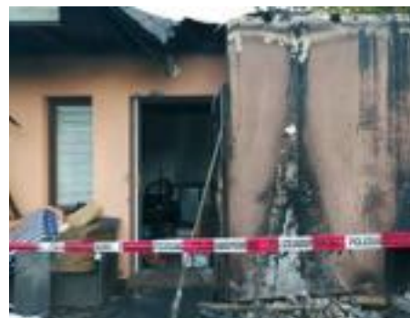
Brandschäden sind besonders ärgerlich und kostenintensiv. Foto: SLK
